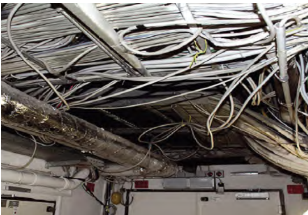
Kabelsalat. Foto: Theater Osnabrück
